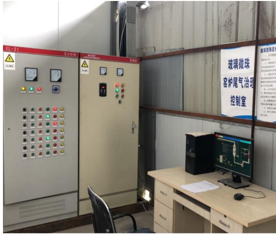
玻璃炉窑废气控制室
