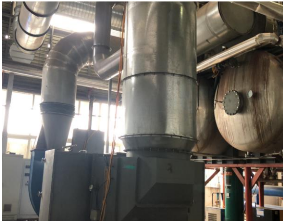
有机废气回收装置
