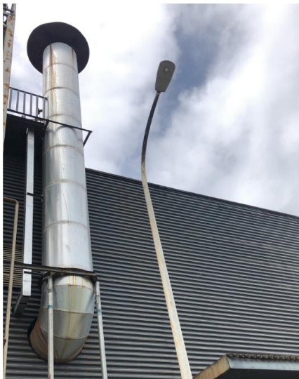
有机废气排气筒筒
