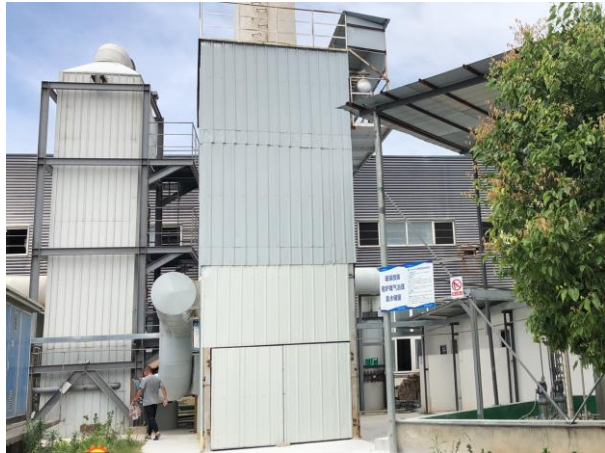
玻璃炉窑废气SCR处理设施及排气
